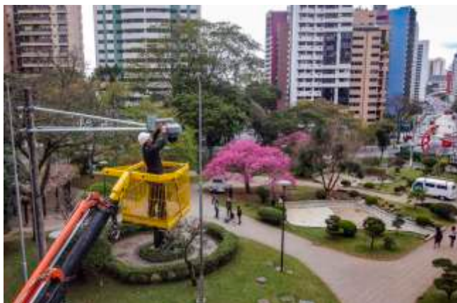
Figura 1: Instalação de câmeras de segurança na Praça do Japão. Curitiba, 13/07/2022.
